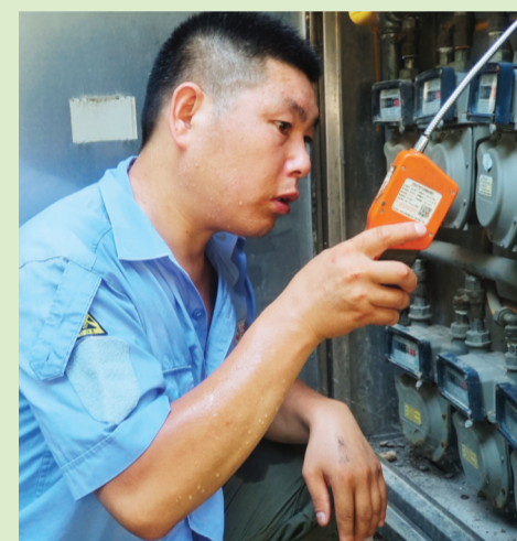
淮南中燃维修人员张标在进行漏气检测 本报记者 柏雪 摄
