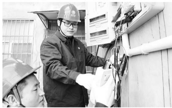
运维人员对线路、设备进行检查
